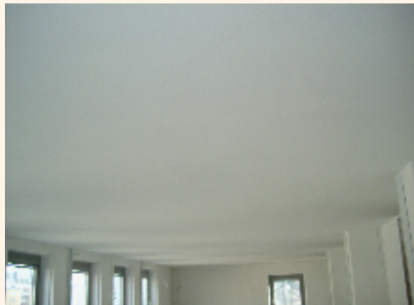
2 Die fertige Decke, mit 5 cm Klimasan-F – einem mineralischen und wärmedämmenden Brandschutzputz – auf F90 ertüchtigt.
